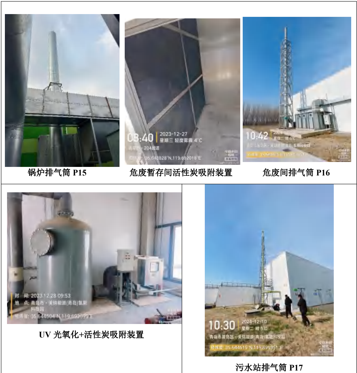
图 4.1-3 废气处理设施及排气筒照片
