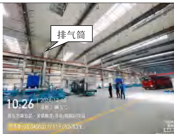
8 台滤筒除尘器及焊接排气筒 P1~P8
