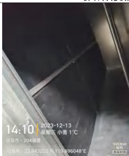
涂装车间袋式过滤器+活性炭吸附装置
