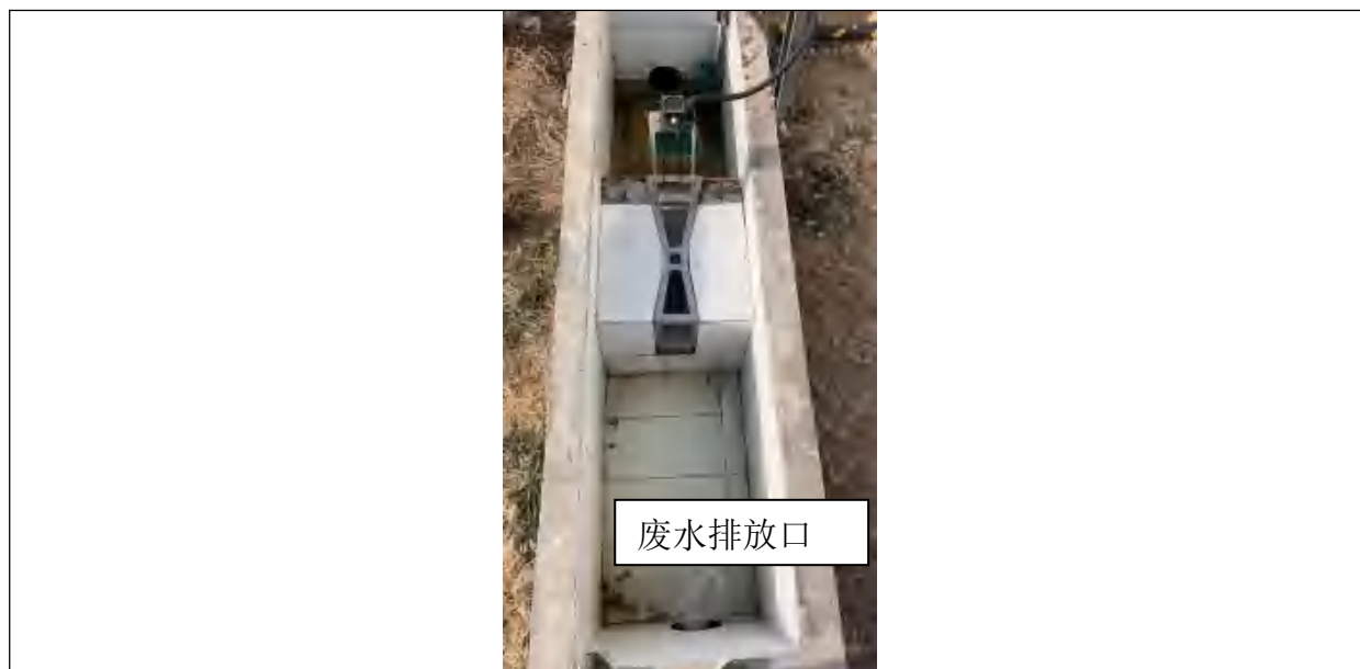
图 4.1-1 项目污水处理站、在线监测及污水排放口照片
