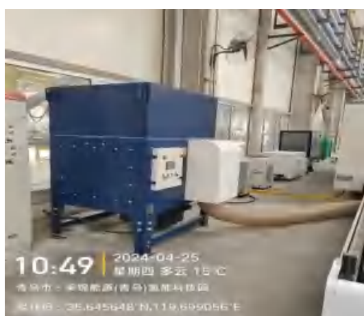
激光切割设备自带收集管线及滤筒除尘器
